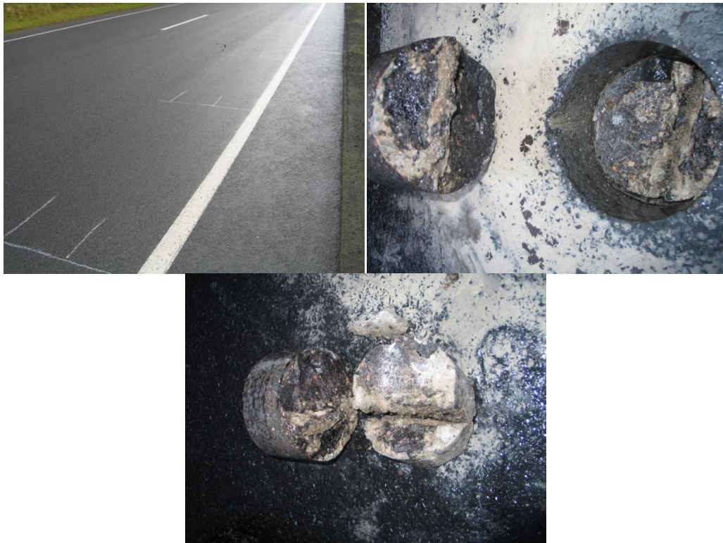
Rysunek 2.8 Sieć zaznaczonych punktów odniesienia użyta przy namierzaniu niewidocznego pęknięcia z precyzją kilkucentymetrową oraz widok otworu i fragmentów rdzenia W2_A1_S zaraz po odwierceniu. Na zdjęciu dolnym widoczne pęknięcie warstwy betonu.
