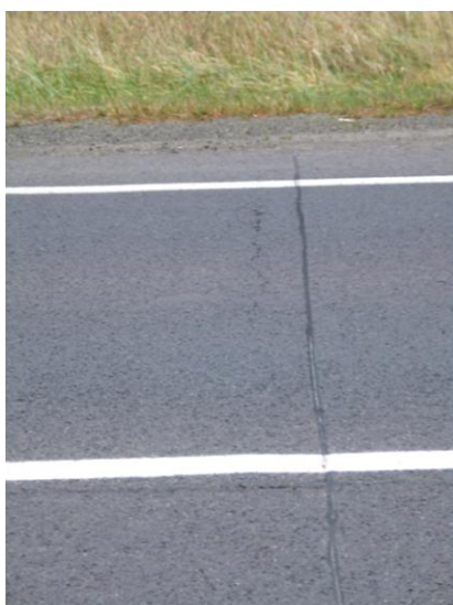
Rysunek 2.2 Typowy wygląd uszczelnionego spoiwem nacięcia w warstwie asfaltowej wykonanego nad dylatacją w leżącym niżej betonie. Obok widoczna powstająca niezgodnie szczelina.
